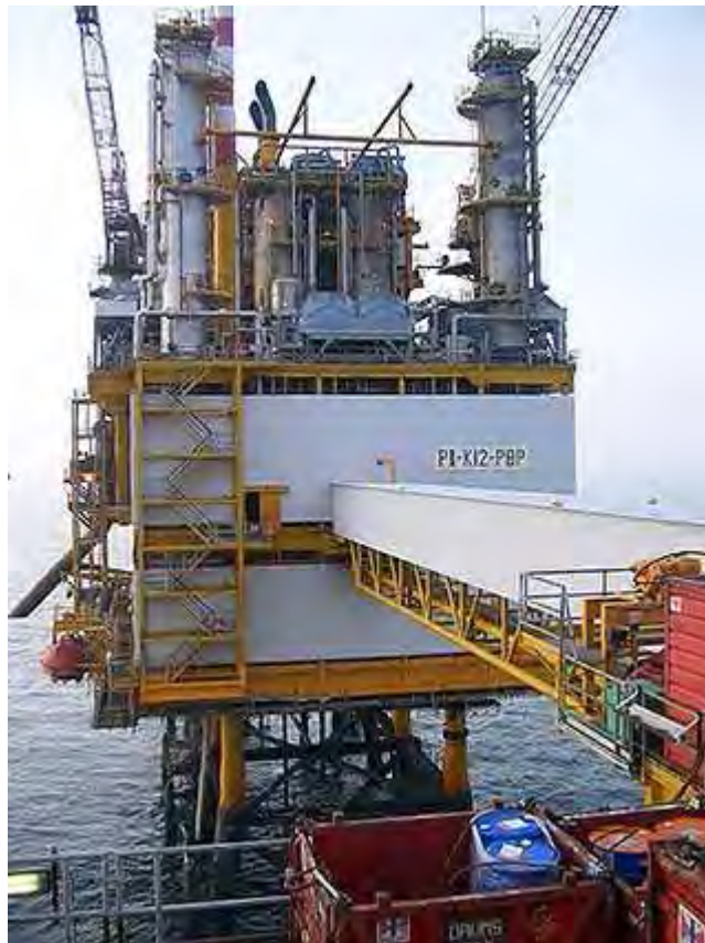
Fig. I.16 Impianto di CO 2 -EGR K12-B
