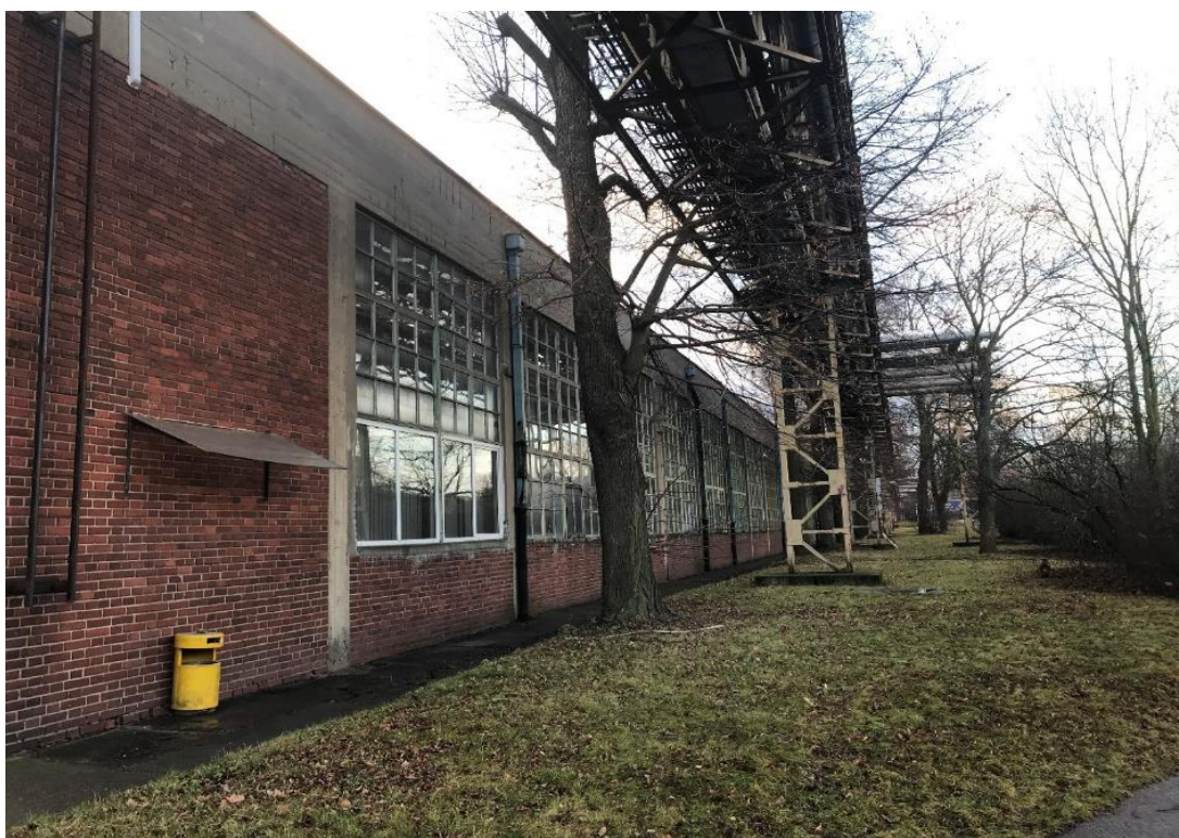
Obr. č. 8 – areál AVIA Letňany, opuštěná výrobní hala, teplovod zdroj: foto autorka 10.1.2020
