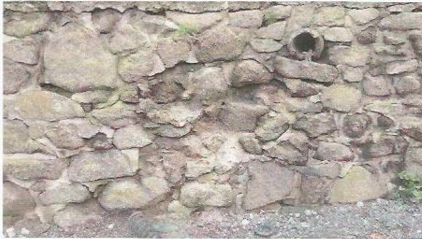
Snímek číslo 20: Poškozený kamenný taras
