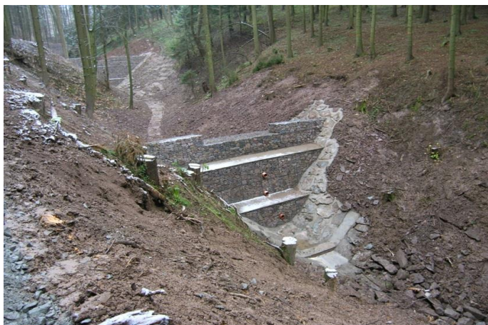
Obr. 6 - Přehrážka se svodným příkopem v k.ú. městyse Lysice (Zdroj: spucr.cz)
