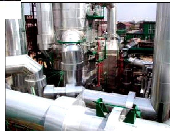
Kyselina sírová je vyráběna na nejmodernějším zařízení
