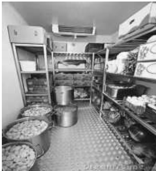
Εικόνα 25: Υγιεινολογικά ορθή αποθήκευση σε ψυκτικό θάλαμο
