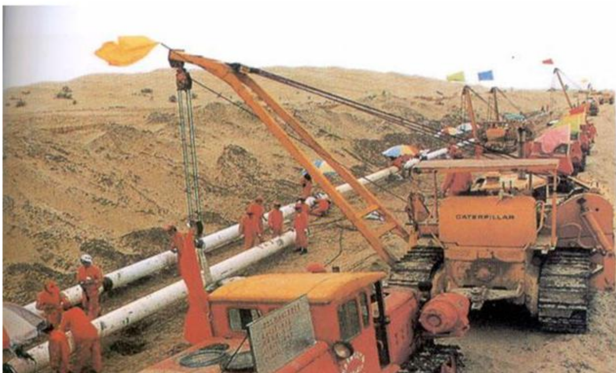
Рисунок 8.4. – Нарушенные земли (прокладка трубопроводов)
