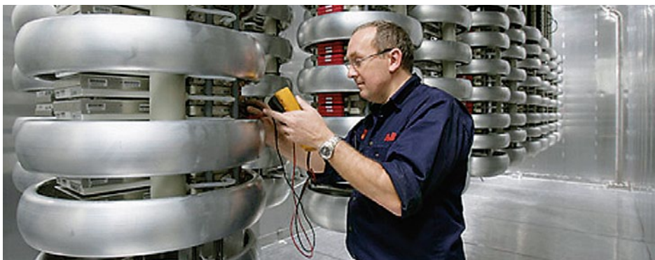
2009 Technik ABB testuje usměrňovače HVDC Light (odlehčená verze HVDC) využívané k připojení nejvzdálenější větrné elektrárny na světě, ležící 125 km od německého pobřeží.
