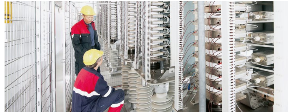
2009 Instalace FACTS pomáhá uspokojit rostoucí poptávku po elektřině v Norsku. Technologie FACTS dokážou zvýšit bezpečnost, kapacitu a přizpůsobivost přenosových systémů.
