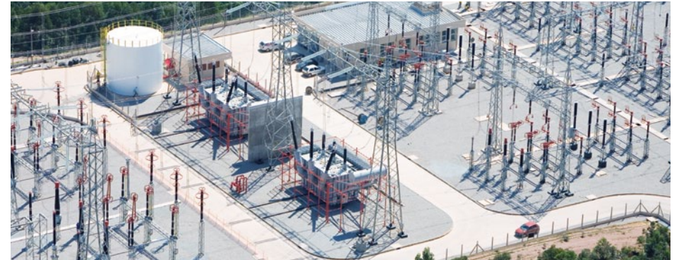
2007 Vzduchem izolovaný rozváděč pro napětí 440 kV instalovaný poblíž města Sao Paulo v Brazílii.
