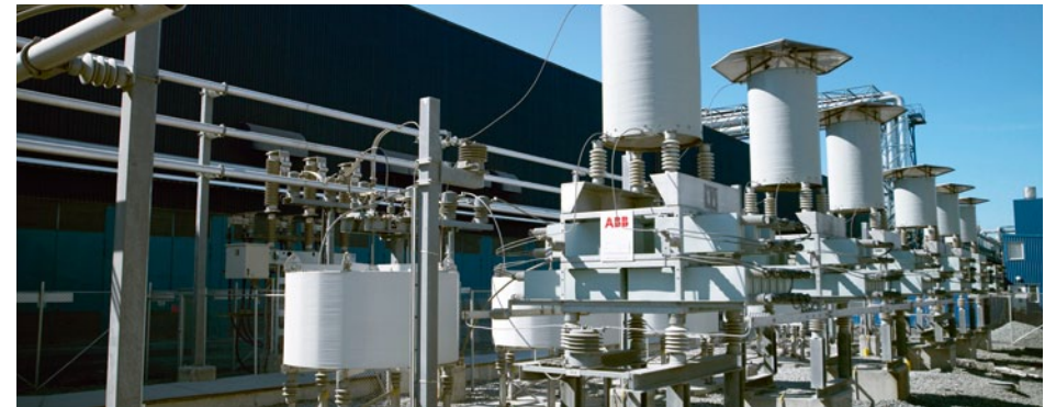
2005 Instalace FACTS ve Finsku, stabilizující výkyvy napětí i proudu. Technologie pomáhá eliminovat rušení místních elektrických sítí, vyvolávající např. blikání světla (flicker) nebo další problémy.
