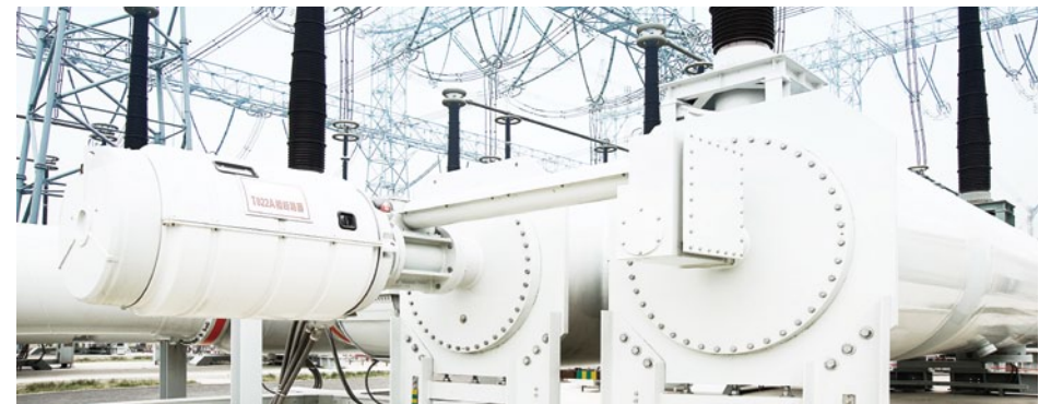
2009 ABB zprovoznilo plynem izolovaný rozváděč pro ultra vysoké napětí dosahující rekordních 1 100 kV, který dále zvýšil účinnost dálkových přenosů elektrické energie.
