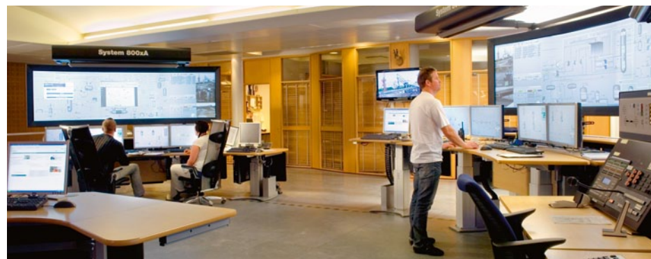
2005 V tomto roce způsobila společnost ABB svým systémem 800xA a rozšířeným pracovištěm obsluhy (Extended Operator Workplace) převrat ve zdokonalení efektivity obsluhy a vzhledu velínu, jak dokazuje plynárenská stanice Tjeldbergodden v Norsku.
