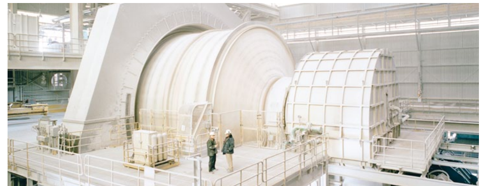
Měděný důl Collahuasi v severním Chile využívá k optimalizaci provozu řadu produktů ABB z oblasti energetiky a automatizace, včetně systému 800xA a bezpřevodového pohonu drtičů (viz obrázek), který je největší na světě.
