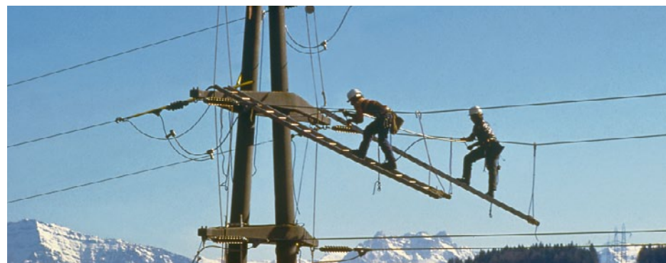
2006 Techničtí odborníci integrují kabely z optických vláken do stávajících přenosových vedení pro švýcarský závod EKZ. Komunikační zařízení společnosti ABB jsou využívána k přenosu zvuku, informací a bezpečnostní signalizace přes vedení vysokého napětí po celém světě.
