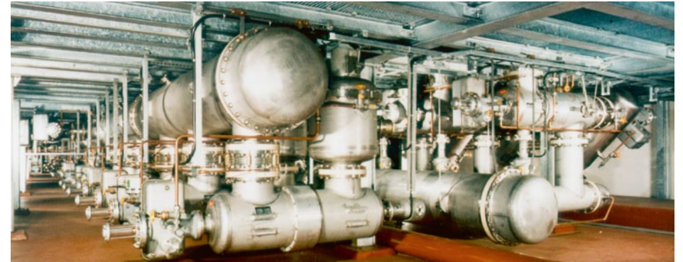
1966 Do švýcarského Sempersteigu dodán plynem izolovaný rozváděč jako jedna z prvních instalací na světě. Ke zprovoznění došlo v roce 1967.
