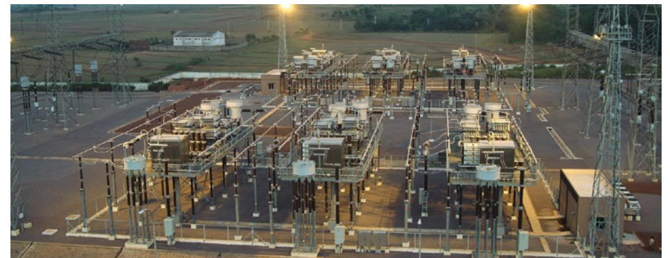
Instalace FACTS v indickém Raipuru, umožňující přenos elektrické energie z rozvodné sítě ve východní Indii na západ a jih.
