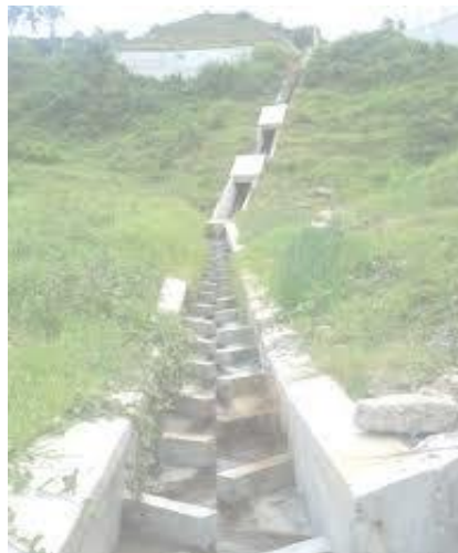
Fotografía 4.8-4 Disipador de energía
