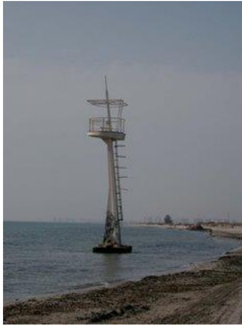
Imagen 87: torre socorrista que quedó fuera de la playa seca por la regresión de la línea de costa (ya retirada en el año 2009)
