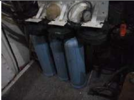
Fotografía 11: Planta de tratamiento de aguas residuales (PTAr), dentro de la embarcación.
