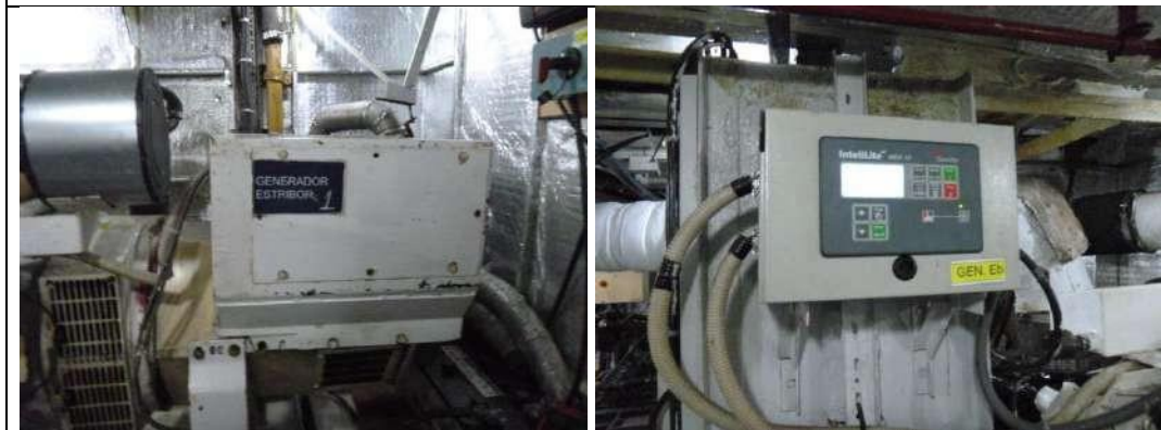
Fotografía 25.- Vista lateral del generador a estribor – Panel de control del generador a estribor
