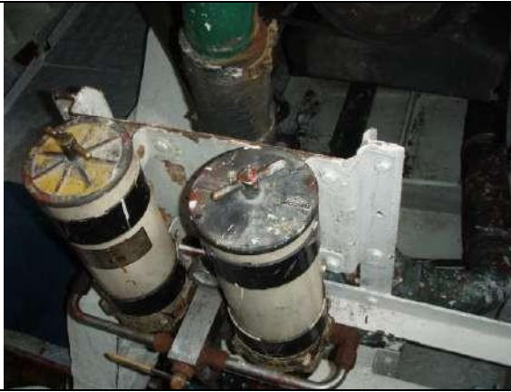
Fotografía 39.- Purificadores y filtros
