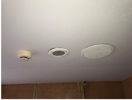
Fotografía 7: Detectores de humo
