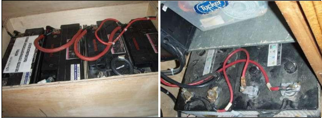
Fotografía 27.- Banco de baterías para equipos de navegación y comunicación, y de emergencia ubicados en el puente de gobierno
