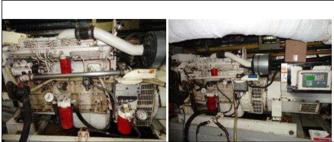
Fotografía 24.- Generadores a babor y estribor
