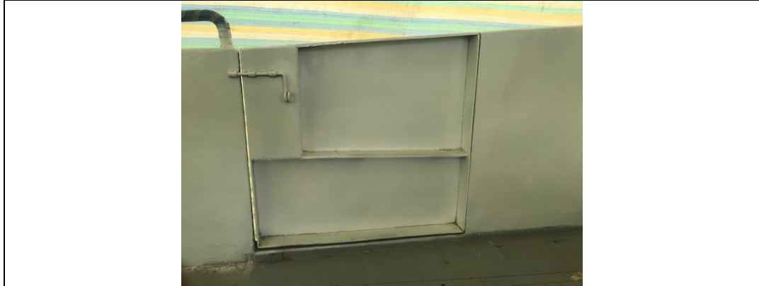
Fotografía 180.- Puerta para entrada y salida de buzos al océano.
