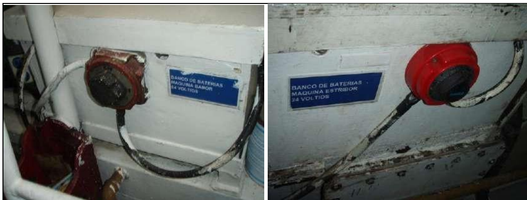
Fotografía 26.- Bancos de baterías para prendido de máquinas a babor y estribor
