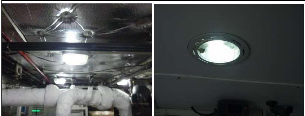
Fotografía 29.- Iluminación interior con luz blanca
