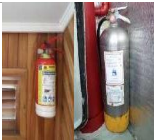
Fotografía 1: Extintores portátiles de PQS, CO2 y FOAM.
