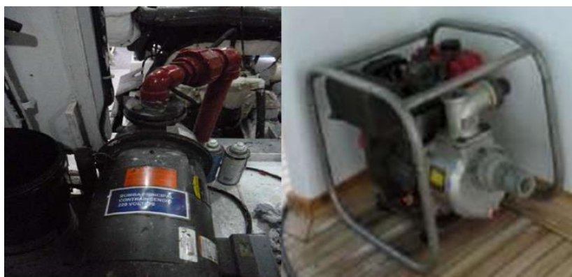
Fotografía 43.- Bomba de achique y contra incendios – Bomba contra incendios portátil
