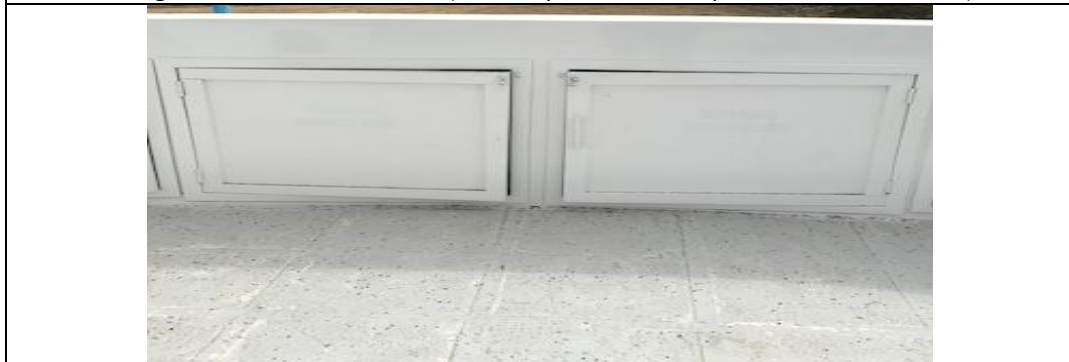
Fotografía 5.- Compartimentos para almacenamiento temporal de desechos
