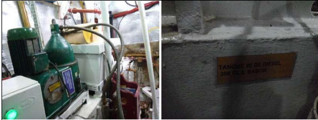
Fotografía 38.- Bomba de transferencia – Tanque para uso diario
