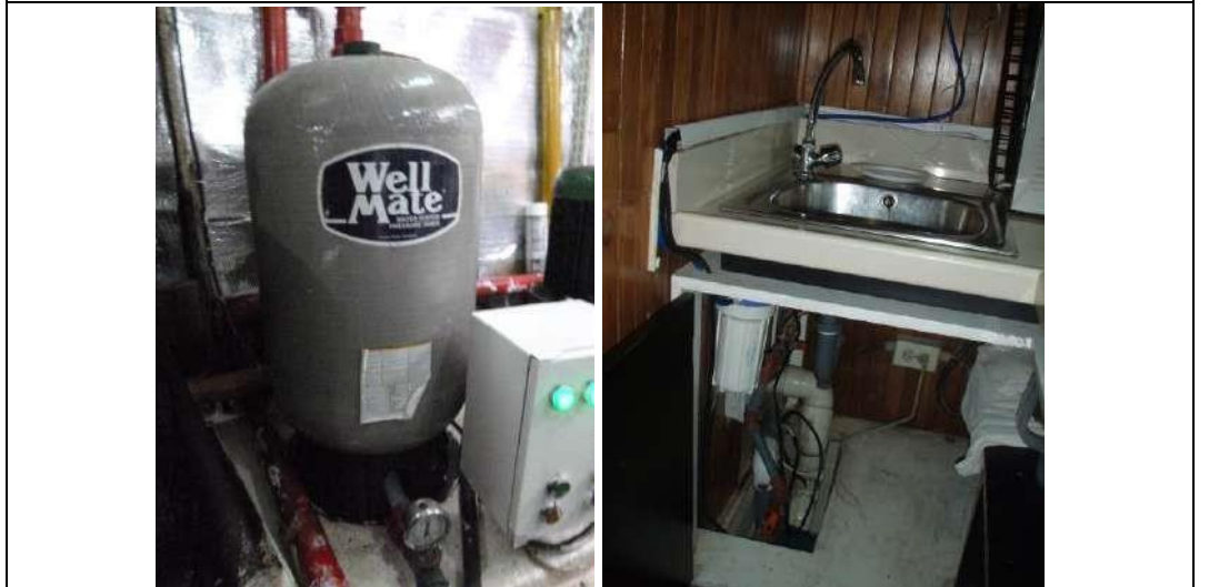
Fotografía 35.- Tanque hidrófobo – Filtro carbón activado
