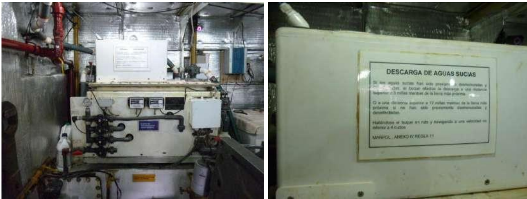
Fotografía 36.- Planta de tratamiento de aguas residuales
