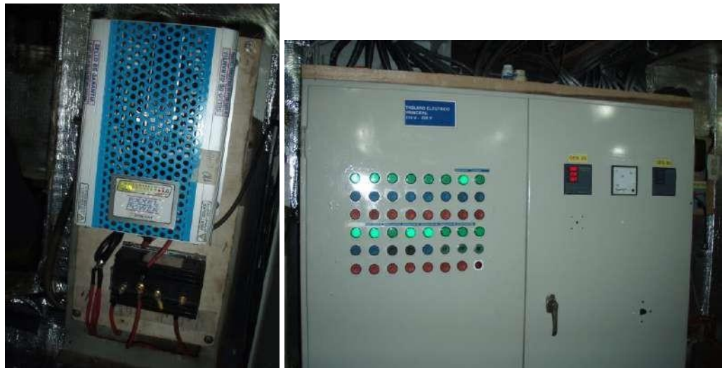
Fotografía 28.- Cargador de baterías – Tablero eléctrico principal
