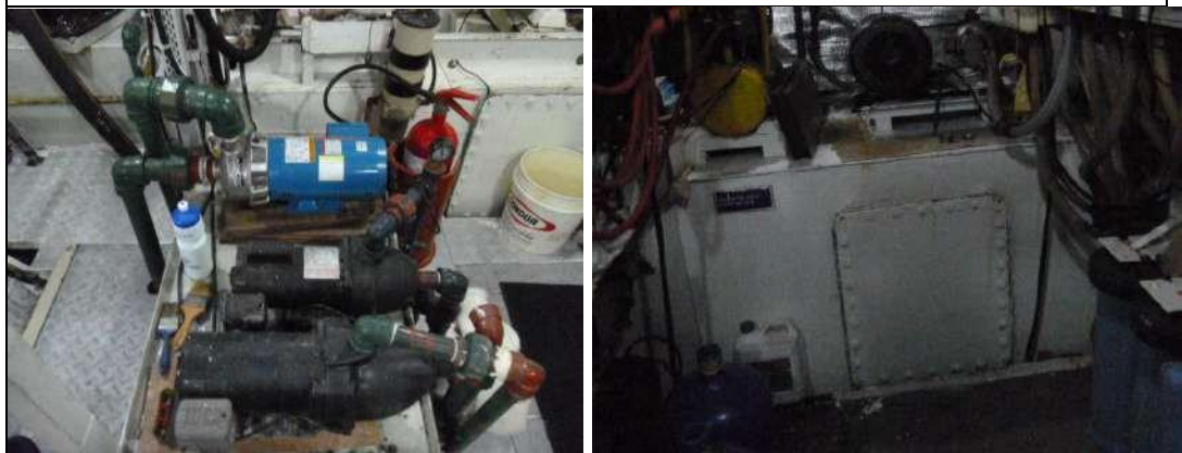
Fotografía 34.- Bombas de alta y baja presión – Tanque de almacenamiento agua dulce
