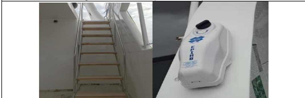
Fotografía 8.- Escalera de acceso (área de descanso) – Equipo EPIRB (Emergency Position Indicating Radio Beacon – Radiobaliza indicadora de posición de emergencia)
