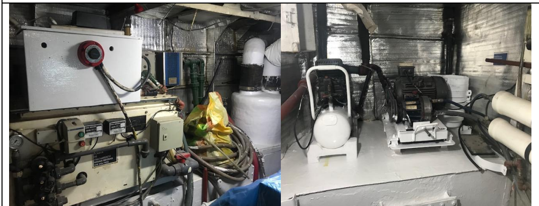
Fotografía 20.- Sala de máquinas
