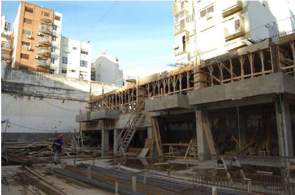
ESTADO DE LOSAS DEL SECTOR FONDO
