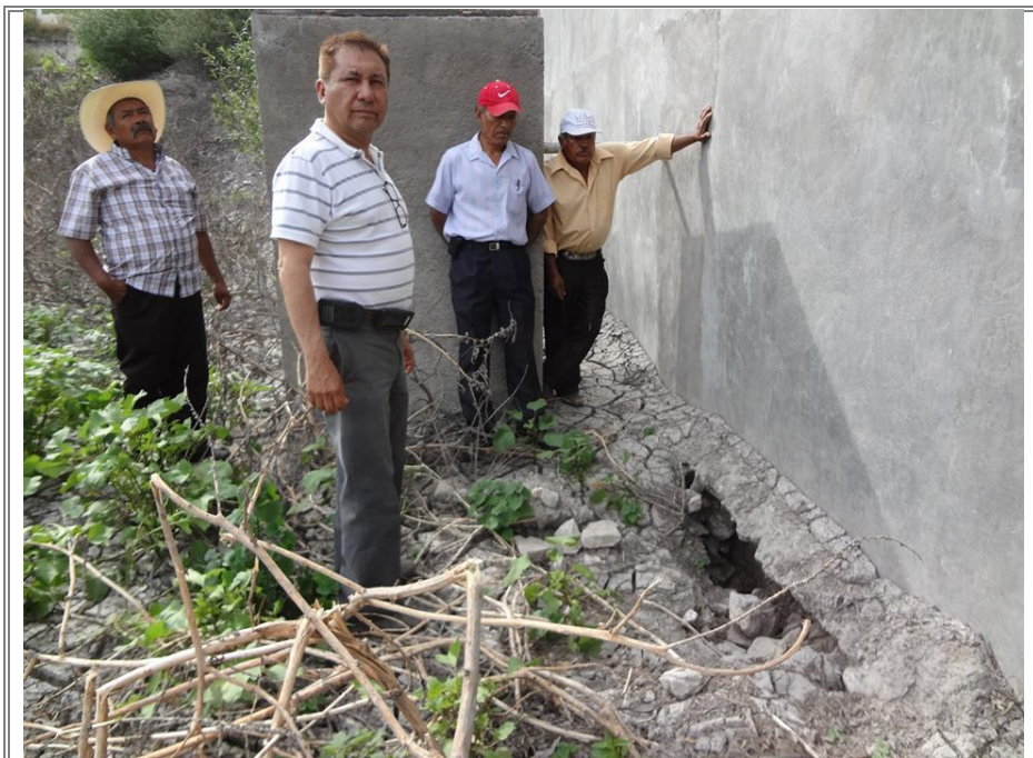
Diputado Lic. Sergio Gomez Olivier haciendo la verificación de los muros de contención de la represa.
