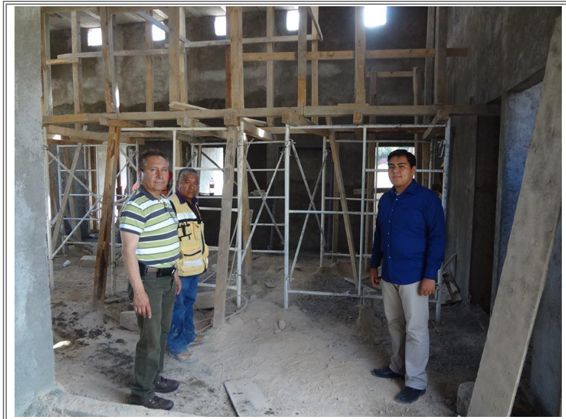
Diputado Lic. Sergio Gómez Olivier realizando una revisión del interior de la obra.
