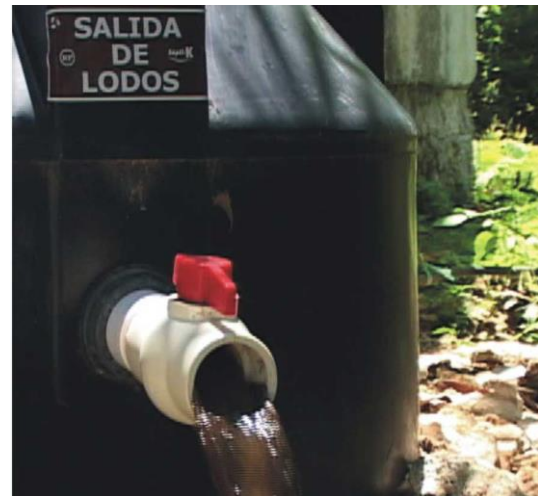
Válvulas para extracción de Lodos
