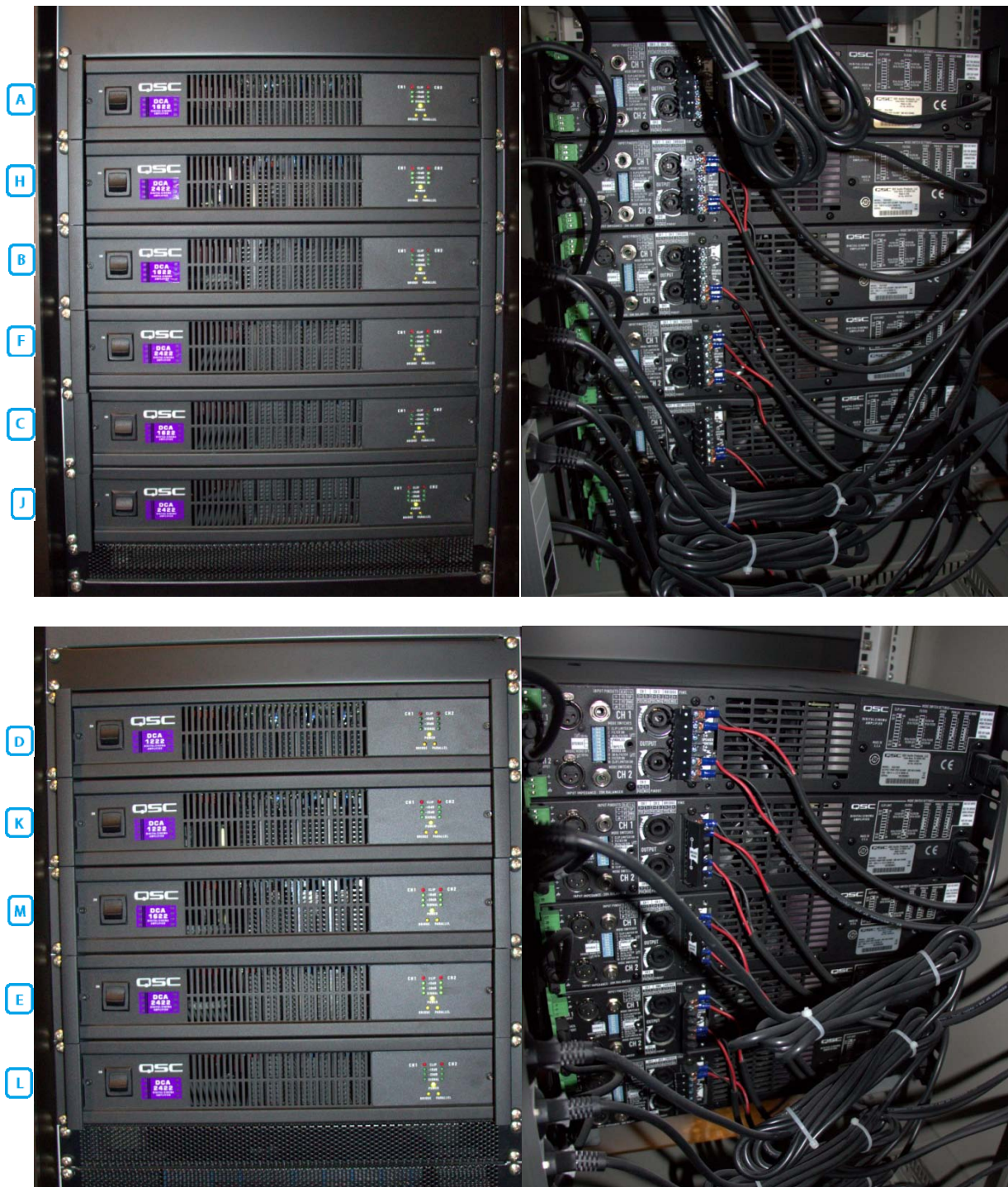
Imagen 198: Conexionado amplificadores. Sala real
