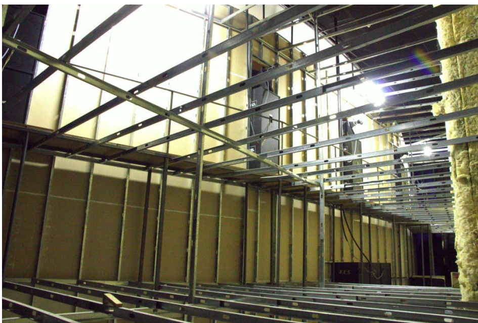
Imagen 5: Sala de mantenimiento detrás de la pantalla
