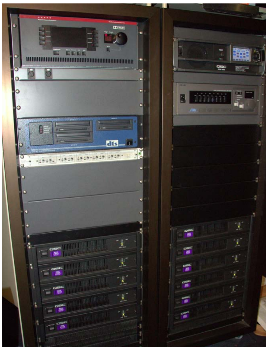
Imagen 194: Rack de equipos en la sala.
