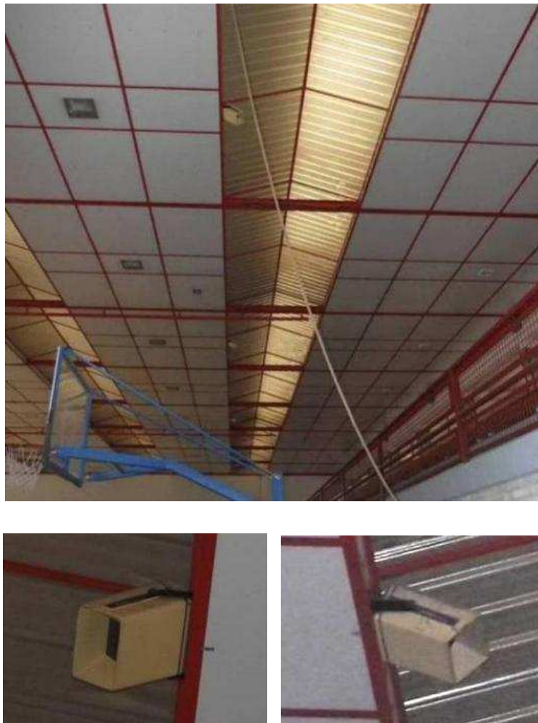
Figura 6. Actual sistema de megafonía instalado
