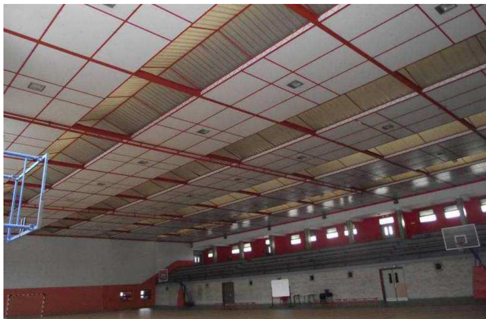
Figura 13. Estado actual de recinto principal del polideportivo
