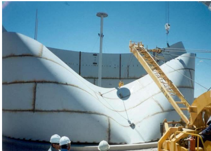
Figura 6: Fallo por falta de soldadura
