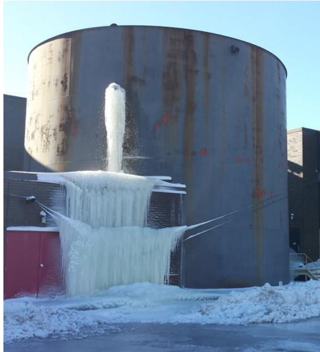
Figura 9: Fallo por corrosión
