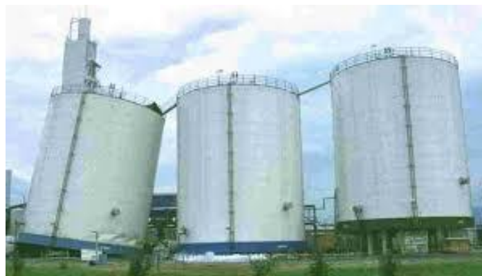
Figura 10: Fallo por terremoto
