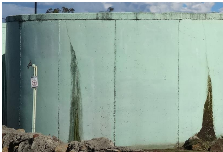
Figura 8: Fallo por pequeños movimientos de tierra
