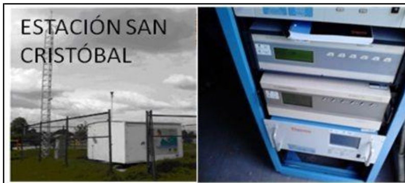
Imagen de la Estación de la RMCAB en San Cristóbal-Fuente Secretaría Distrital de Ambiente
