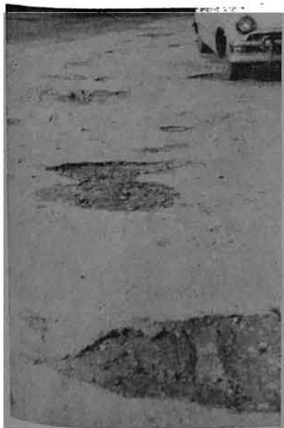
Tratamento: Reforma completa do asfalto com a máxima urgência. Não resolve "tratamento sintomático."
