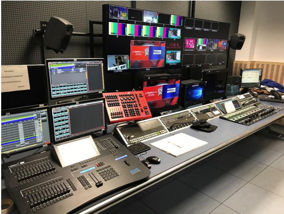
Figura 3: Control de cámaras e iluminación
