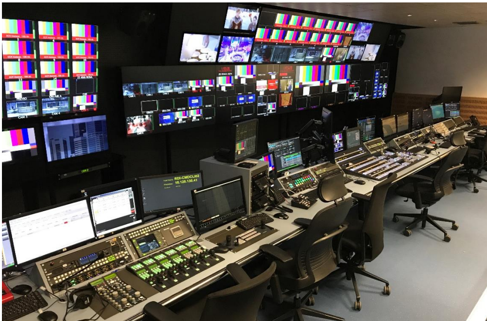
Figura 7: Control de realización al que se le ha incorporado la zona del control de cámaras e iluminación
