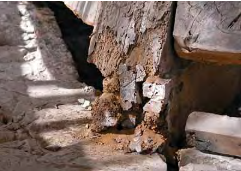
Abb. 6: Schäden am Dachstuhl durch den gescheckten Nagekäfer
