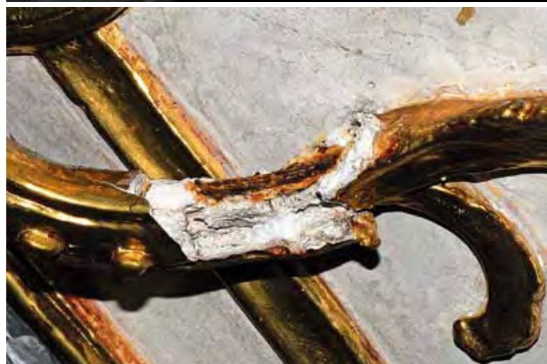
Abb. 5a, b, c: Typische Schadensbilder 5a: aufbrechende Schalen infolge Salzdruck; 5b: „Salznester“ meist zwischen Fein- und Kernstuck; 5c: Korrosion der Drahtarmierung unter abgefallenem Stuckteil (Fotos: M. Staschull, 2010)
