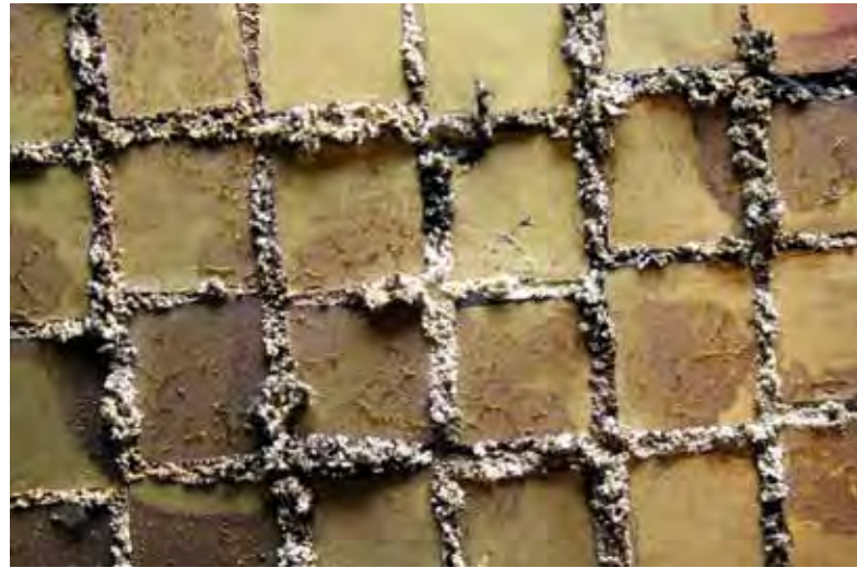
Abb. 8: Ausblühungen im Fugennetz der Mosaiken
