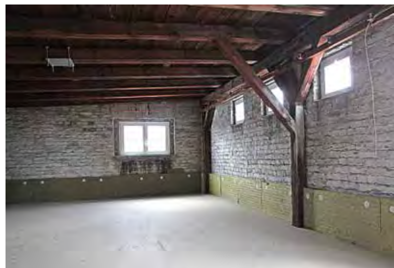
Abb. 29: Wärmedämmung der obersten Geschossdecke, gut erkennbar das Hochziehen der Dämmung zur Vermeidung von Wärmebrücken
