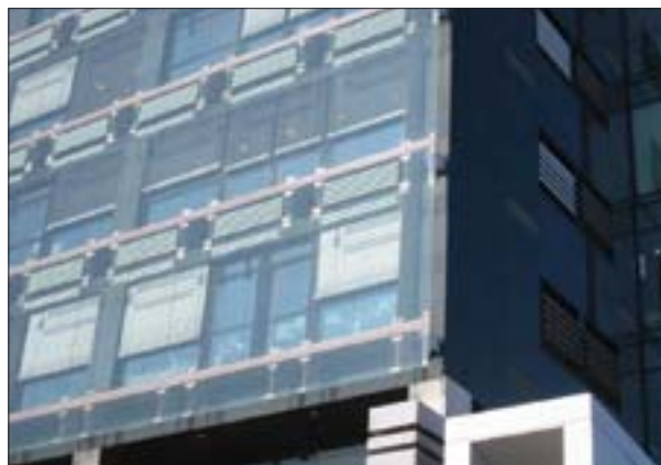
Rys. 16.6.5. Przykład ekranu akustycznego na elewacji budynku (Warszawa – Trasa Łazienkowska). Autor R. J. Kucharski.
