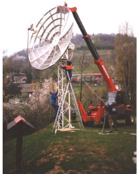
Figura 14 : posizionamento del sistema d'antenna su traliccio di quattro metri.
