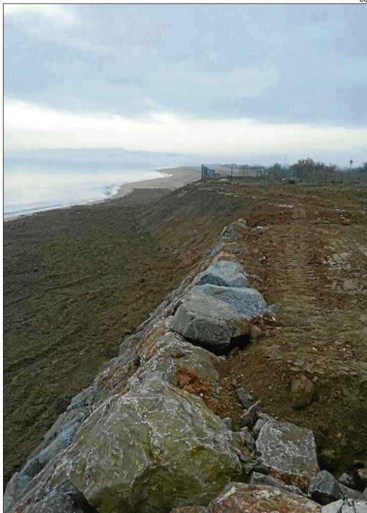
Tram final de l'escullera, amb l'espai del càmping desprotegit.
