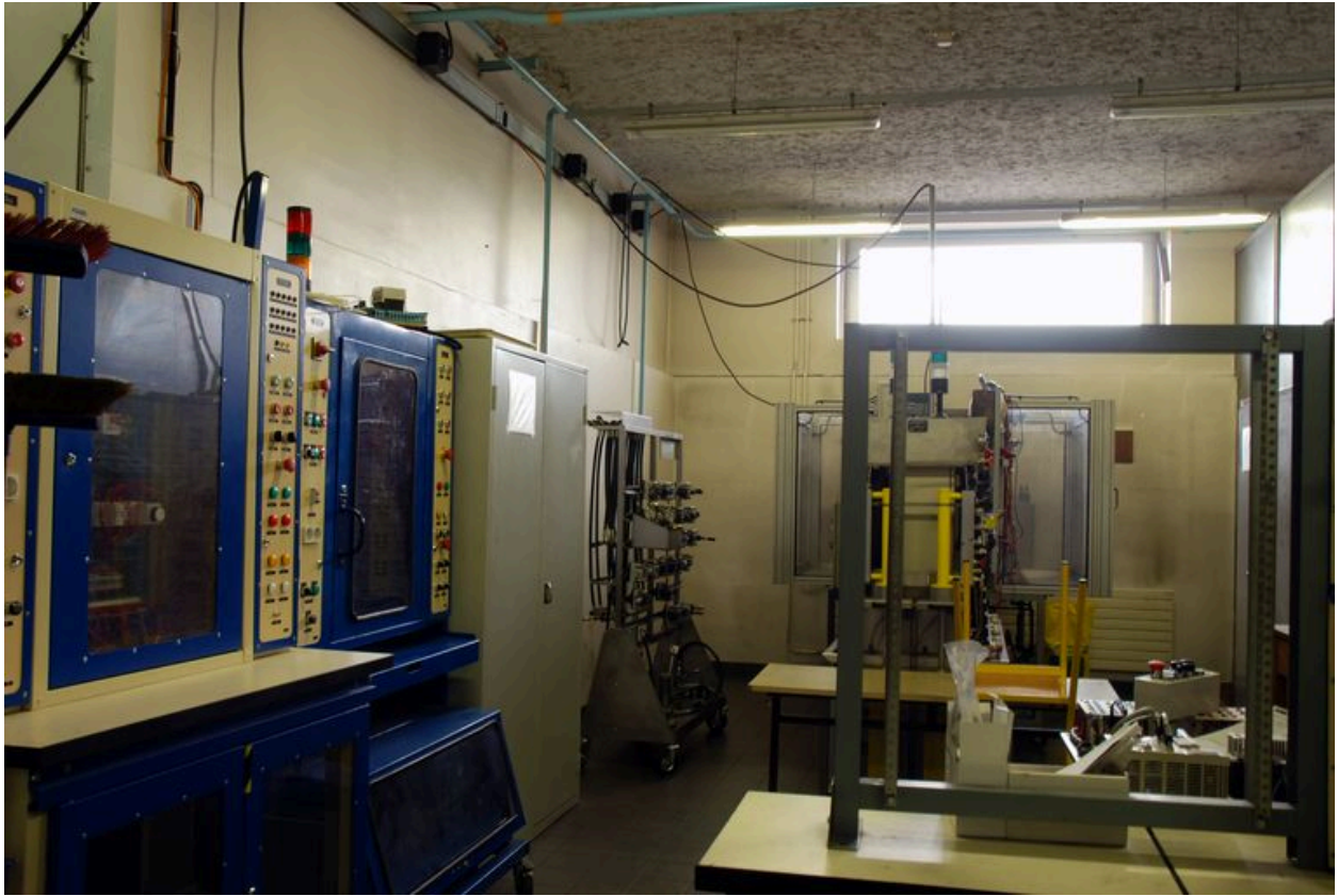
Espace dédié à l'électronique et aux branchements électriques
