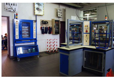
Espace dédié aux branchements électroniques Phot. Catherine Guégan IVR82_20116901937NUCA
