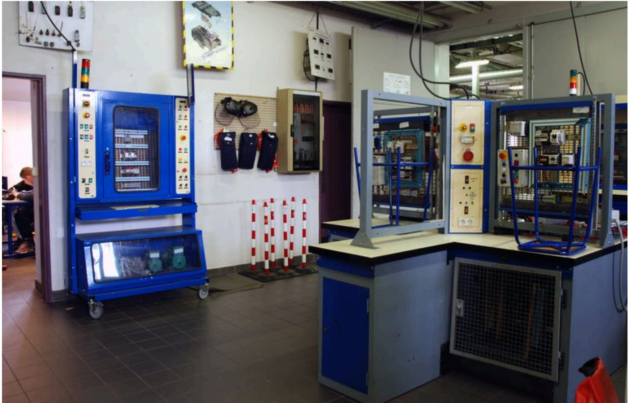
Espace dédié aux branchements électroniques
