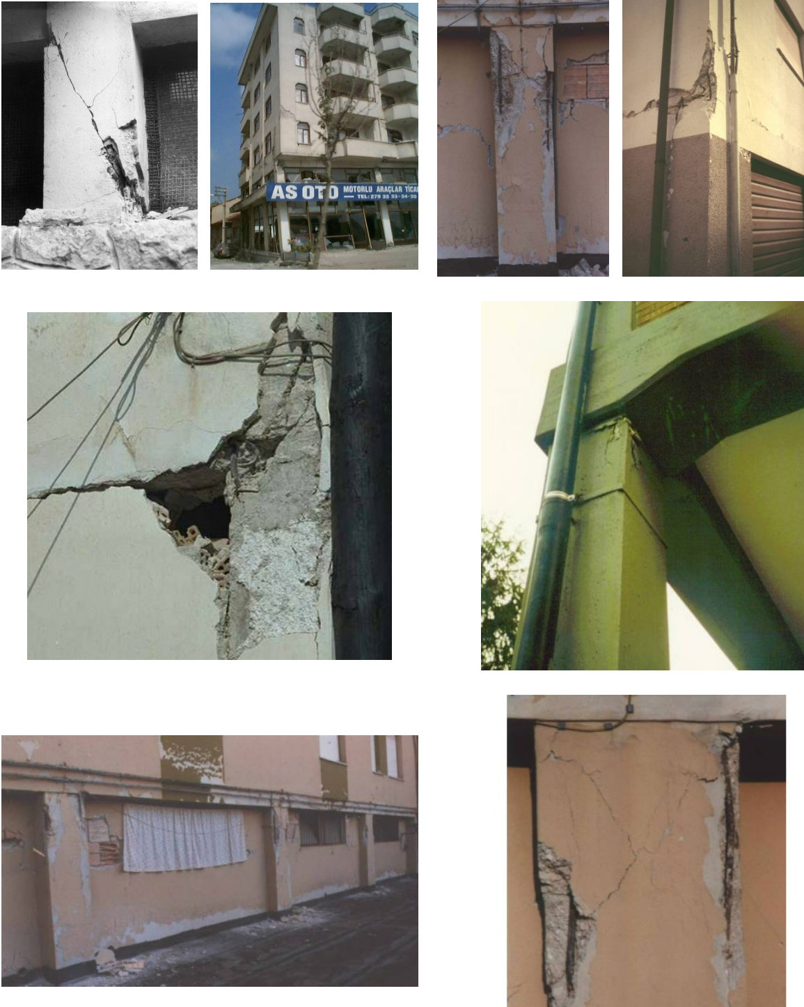
Figura 27: Ejemplos de afectaciones Moderadas en edificaciones de concreto reforzado
