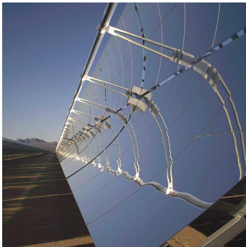
Figure 1.6 : Collecteurs de la centrale solaire Solar One au Nevada
