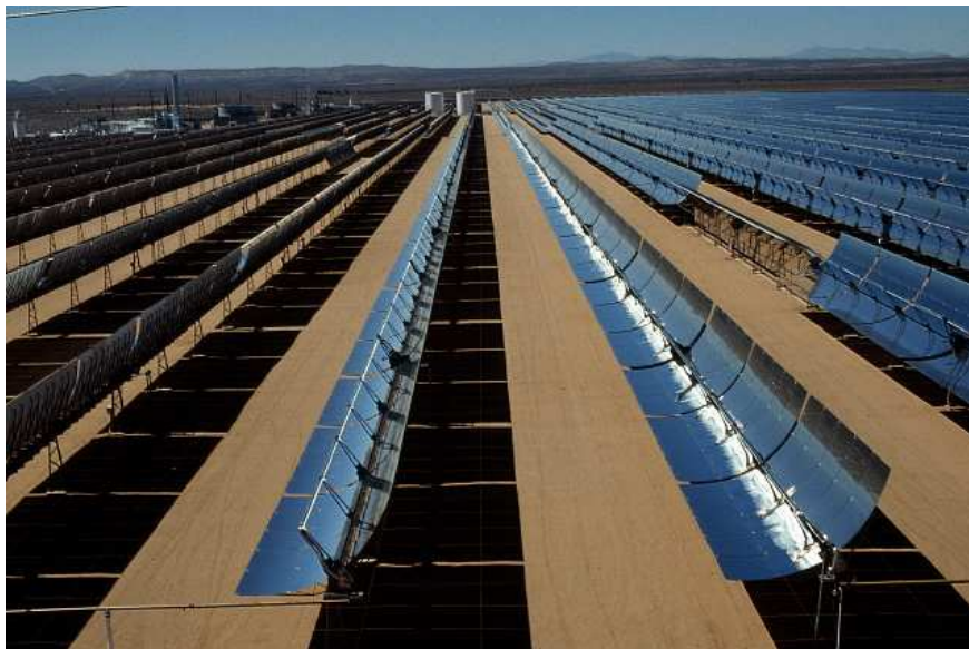
Figure 2.1 : Collecteurs cylindro-paraboliques de la centrale SEGS I à Dagget en Californie
