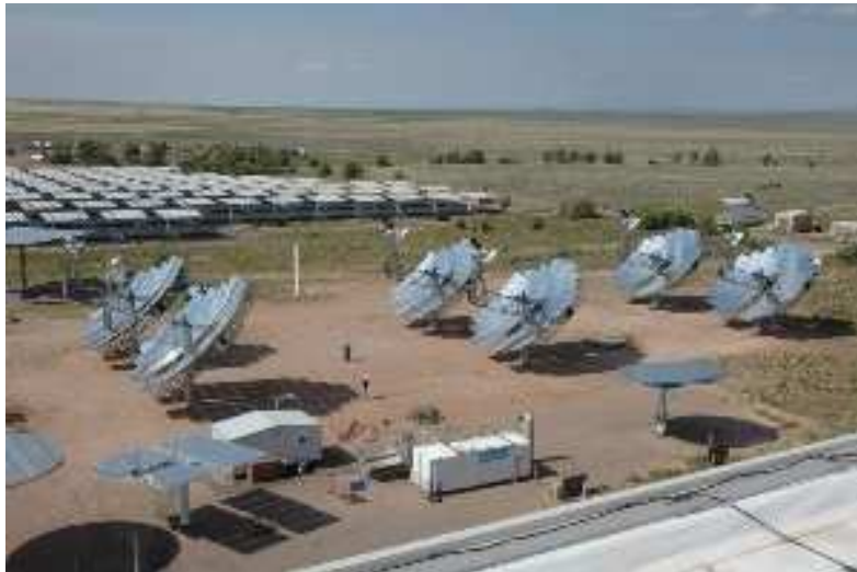
Figure 2.30 : Centrale solaire expérimentale de 6 Parabole/Stirling SES à Albuquerque
