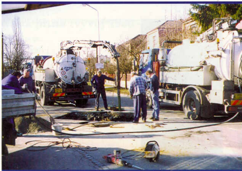
Odstraňování havárie na kanalizačním řadu v Nymburce ve Zbožské ulici
