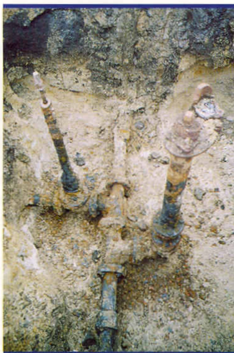
Pohled na původní stav armaturní šachty v křižovatce ulic Komenského a Havlíčkova nefunkční šoupata z roku 1930
