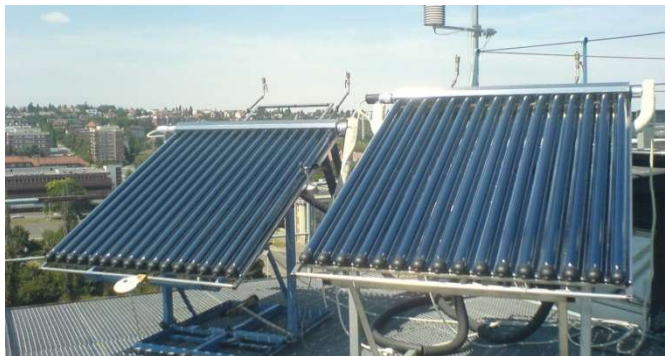
Obrázek 55: Pohled na provedení solárních kolektorů s vakuovými trubicemi
