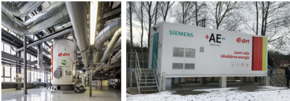
Obrázek 49: Velký elektrokotel v teplárně a bateriové úložiště elektřiny
