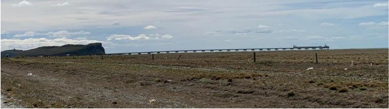
Figura 148. Estructuras portuarias sin terminar y abandonadas al norte de Río Grande. Noviembre 2022.
