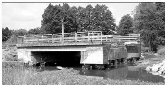
Obr. 5. Porušení násypu bez následku na most
