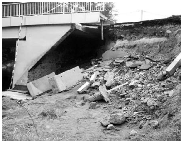
Obr. 8. Částečné porušení násypu
