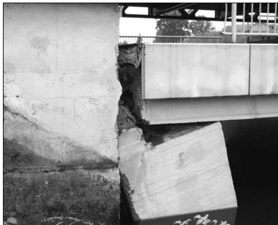
Obr. 6. Pokles a pootočení opěry
