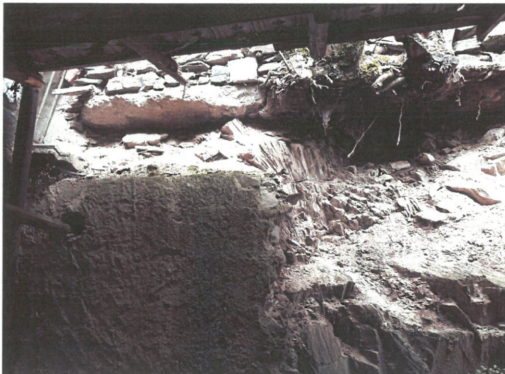
Foto – obnažená betonová deska na vrcholu sesunutí.
