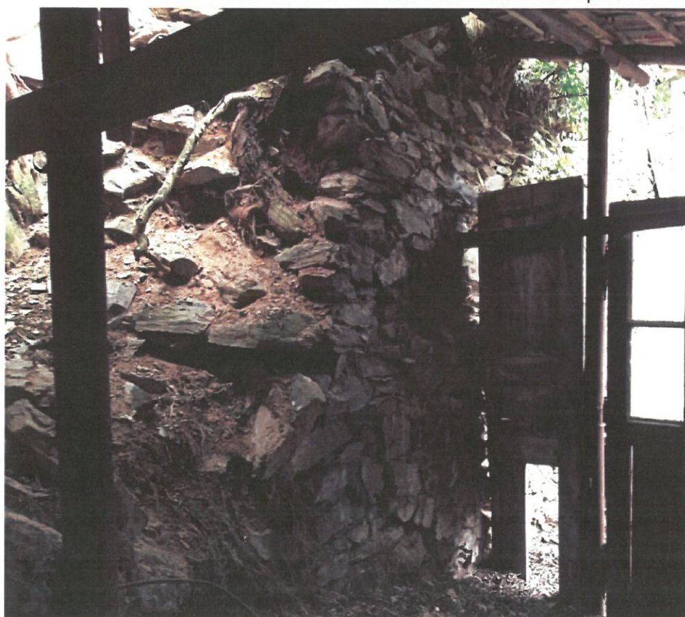
Foto – pohled na přelom zřícené a stojící části kamenné opěrné zdi.
