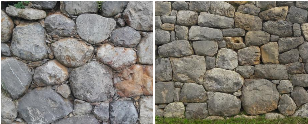
Figuras 5 y 6: Aparejo rústico elaborado con piedras canteadas y abundantes pachillas (izquierda) y con piedras semilabradas a modo de caravista (derecha)
