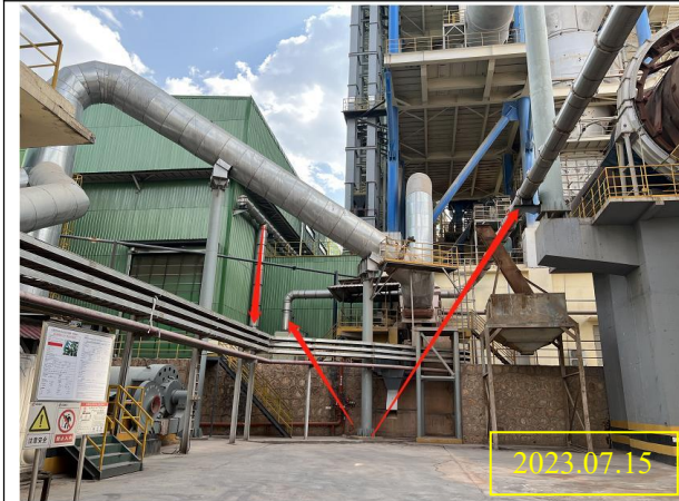
污泥接收框架臭气负压吸附装置
