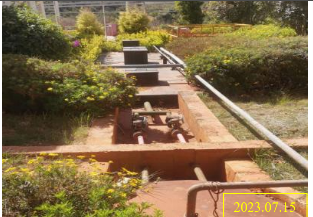
依托厂区现有污水处理站
