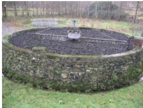
Figura 41. Filtro percolador en una planta rural (Wikipedia).
