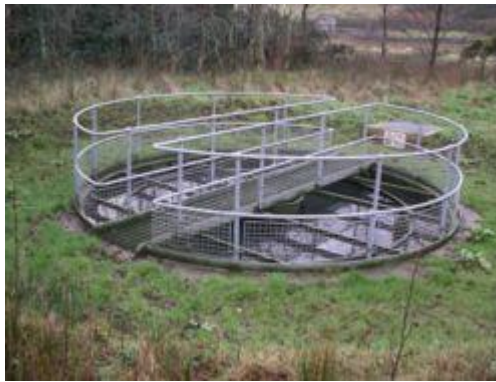
Figura 40. Tanque de sedimentación secundaria en una planta rural (Wikipedia).
