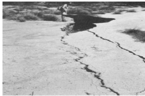
Figura 21. Fisura de tierra en el centro-sur de Arizona. Parte de la fisura en primer plano probablemente sufrirá un colapso por erosión continua debido a los grandes episodios de lluvias (Conway, 2016).
