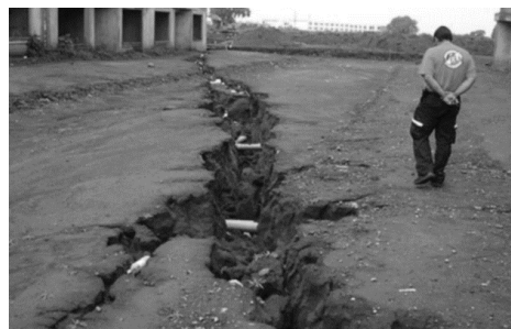
Figura 22. Fisura ubicada en Villas de San Martín, una colonia en el municipio de Chalco, al oriente de la ciudad de México. Referencia: www.bbc.com/mundo/lg/america_latina/2009/08/090806_mexico_grietas_mf
