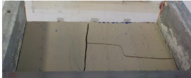
Figura 52. Fisuras adicionales al proceso de asentamiento diferencial. Fuente propia.
