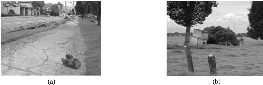
Figura 23. Ejemplos de fisuras en el sector noroccidental de la ciudad de Bogotá (Vesga et al., 2003).
