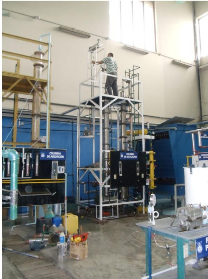
Fig. 54.- Columna de destilación montada en la estructura en el Laboratorio de Operaciones Unitarias.
