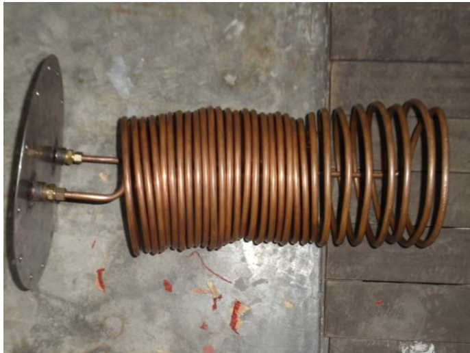
Fig. 67.- Serpentina de cobre de 3/8" en el interior del condensador total.
