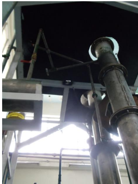
Fig. 86.- Instalación de las líneas de alcohol y reflujo a la columna.
