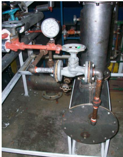
Fig.84.- Instalación de válvulas de vapor, accesorios y manómetros de presión.
