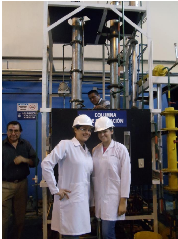
Fig. 87.- Columna de destilación instalada con todos sus cuerpos, líneas, accesorios y medidores de flujo.
