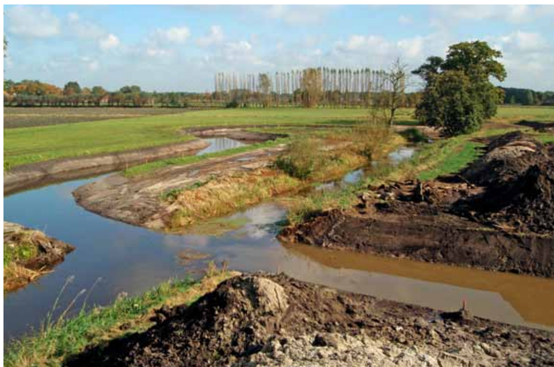
Figuur 5 Natuurontwikkeling aan de Keersop (NB): met behulp van graafmachines krijgt de beek weer een meer natuurlijk traject.
