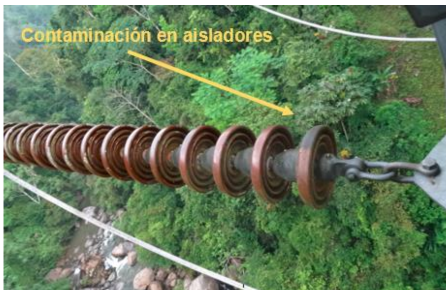
Imagen 10. Cadena de aisladores contaminada. Línea 220 kV 10
