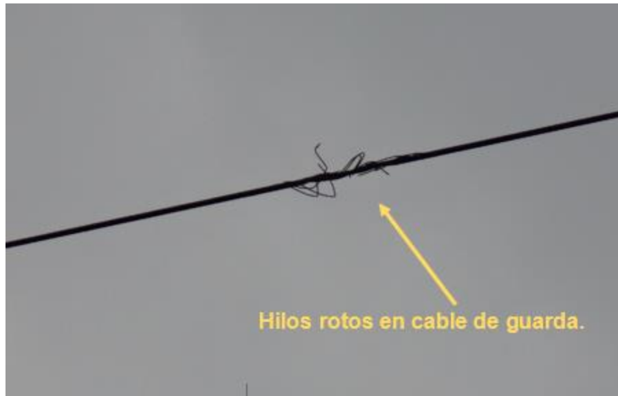
Imagen 11. Hilos rotos en cable de guarda línea de 500 kV 11
