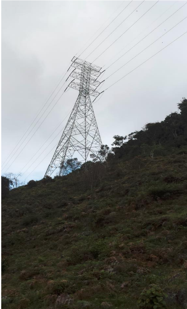
Imagen 1. Torre 220 kV doble circuito convencional
