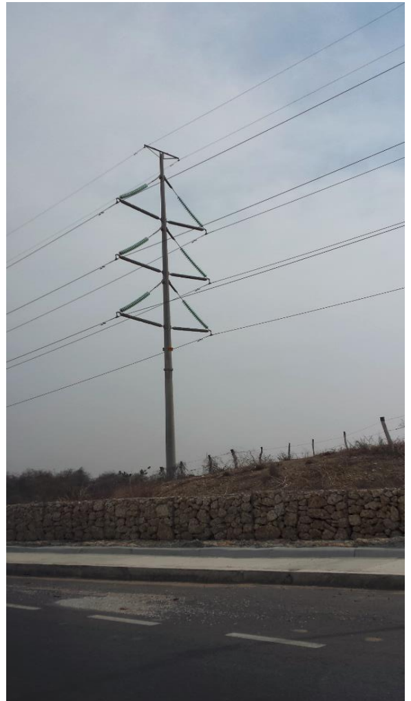
Imagen 2. Poste 220 kV doble circuito compacto
