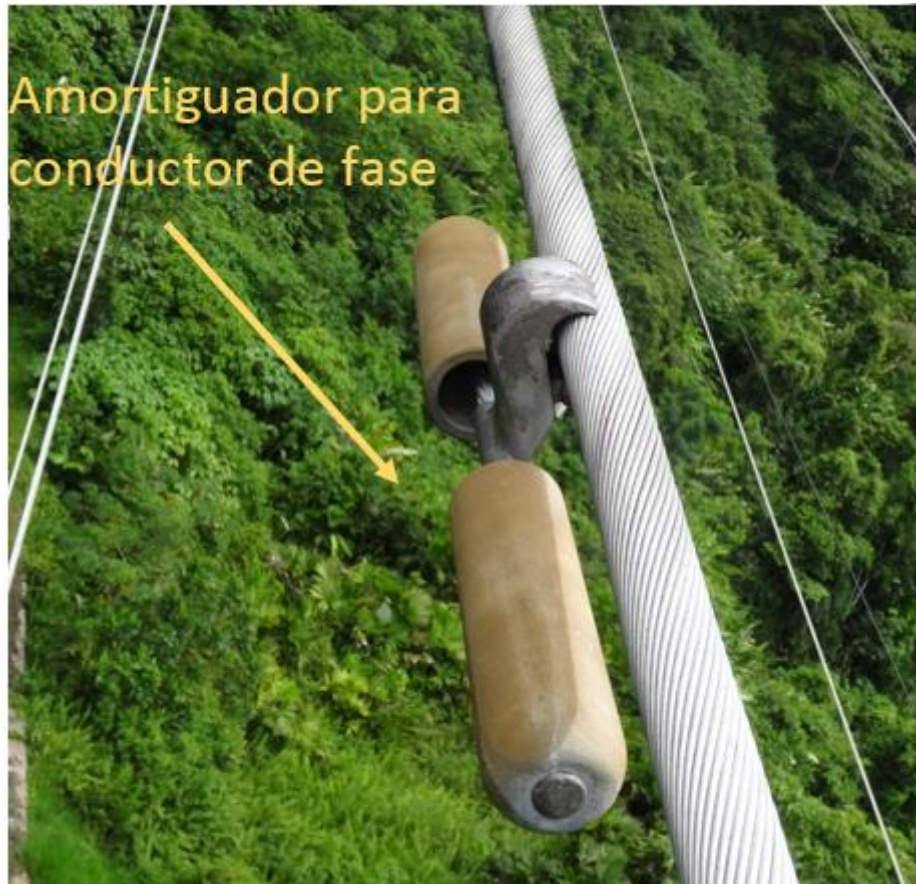
Imagen 13. Amortiguador conductor de fase Línea de 220 kV. 13
