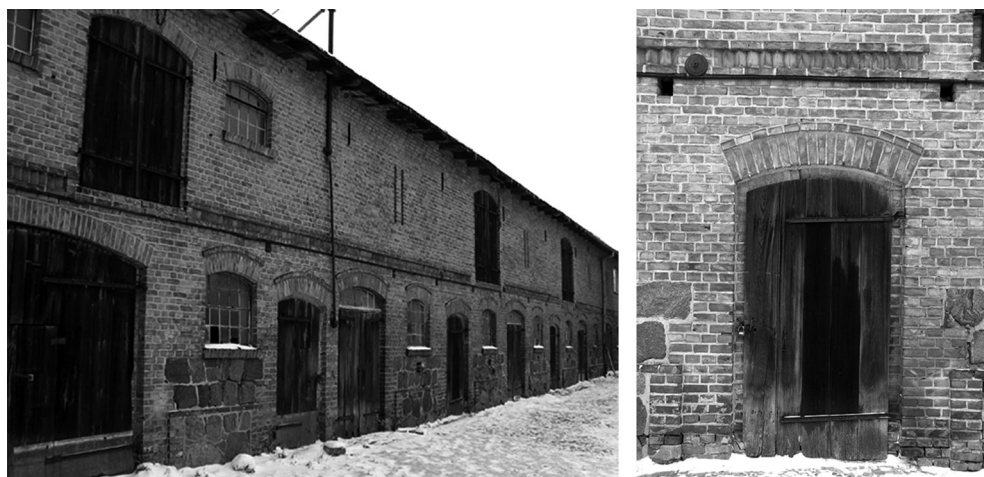
Ryc. 22. Zaniebana i dewastowana kamienno-ceglana XIX-wieczna obora w folwarku Boleszkowice (woj. zachodniopomorskie), stan w 2006 r. (fot. autorka)
