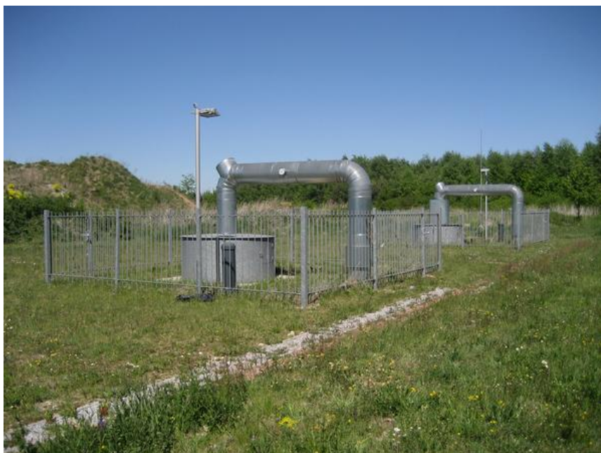
Instalacja geotermalna przy budynku lokalnej sieci ciepłowniczej w Messestadt Riem.
