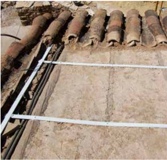
Escuela-horno-barbería de Sesga. Tirantes bajo teja de sujeción de la fachada principal inclinada hacia la calle
