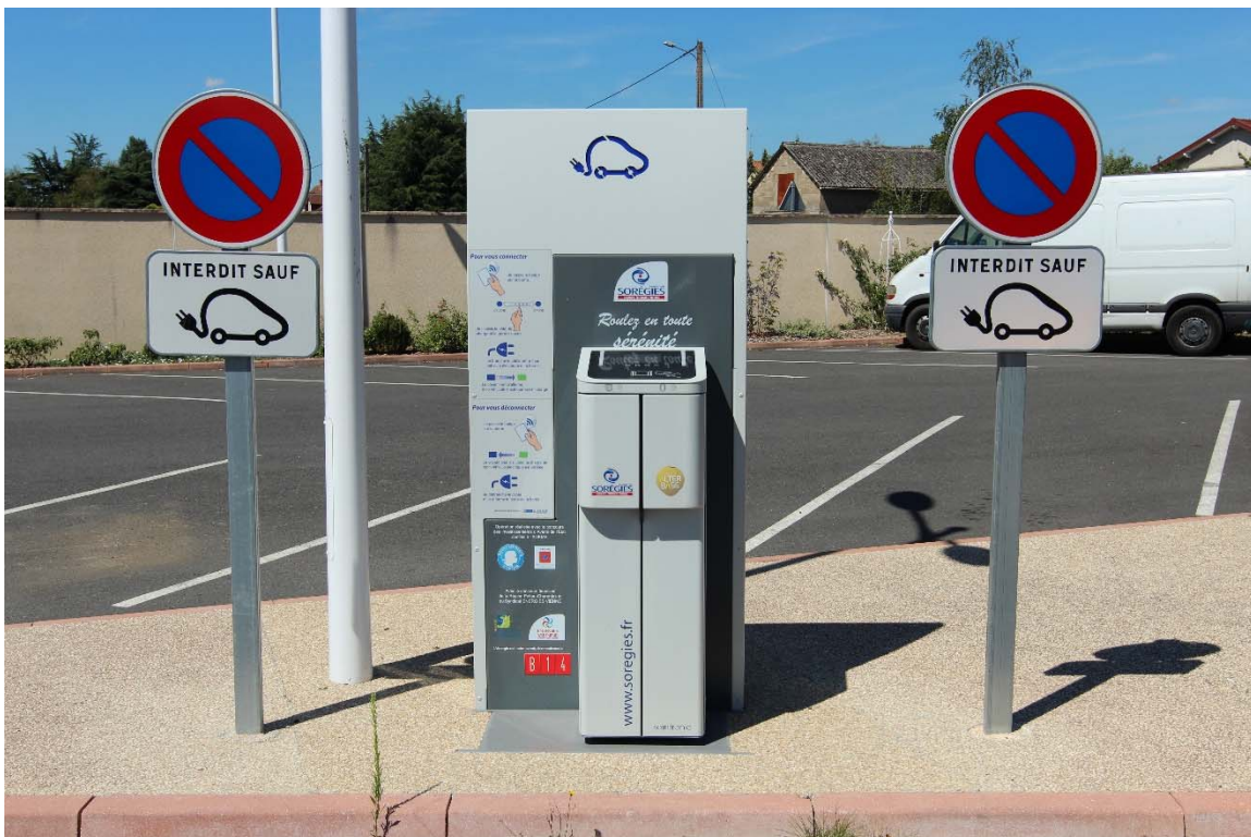
Figure 50 : Exemple de borne de recharge pour véhicules électriques (Source : By Lionel Allorge - Own work, CC BY-SA 3.0, https://commons.wikimedia.org/w/index.php?curid=61265350 )
