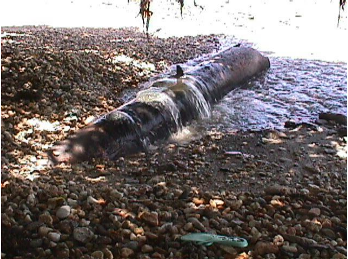
Foto I-10.- Tubería de aguas servidas en la que se aprecia la salida de las aguas directamente en la zona litoral de la playa situada al sur de Güiria.
