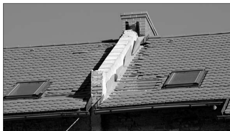
Pod każdym z okien dachowych były murki ogniowe
