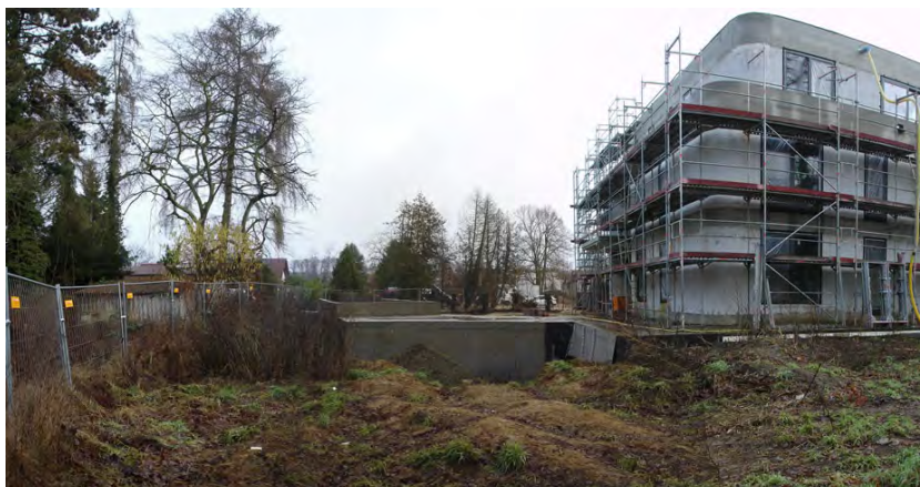
Abb. 11 Blick aus dem Plangebiet nach Osten auf die Tiefgaragen der unmittelbar benachbart zum Plangebiet entstehenden Wohnanlage © Steffen Pfrogner 24.01.2022
