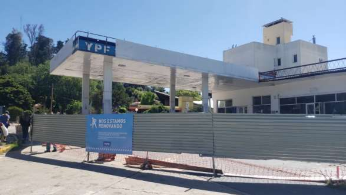
Imagen 10 Estado actual de la EESS
