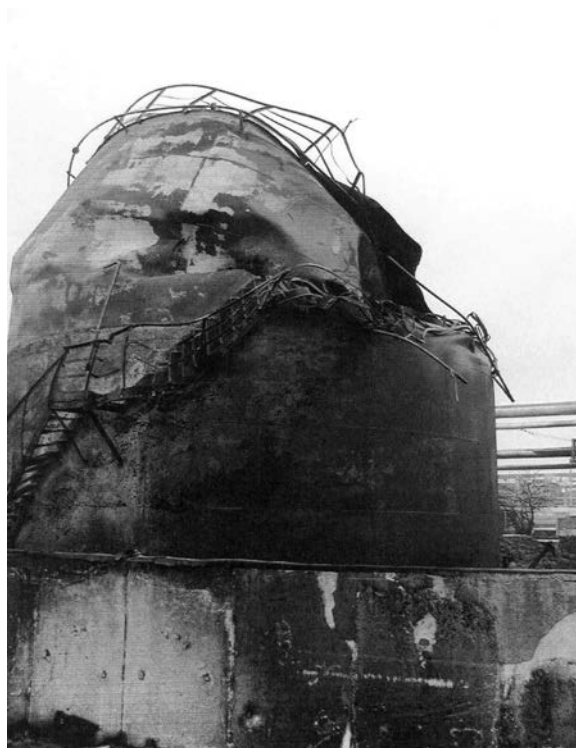
Fot. 4. Deformacja zbiornika ZM1.
