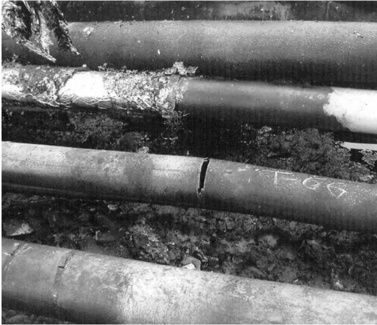
Fot. 1. Pęknięcie rurociągu T-66.
