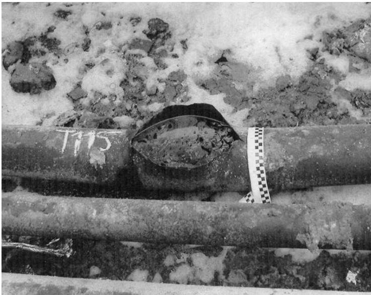
Fot. 2. Zniszczenie rurociągu T-115 wskutek wzrostu ciśnienia wewnątrz rurociągu.
