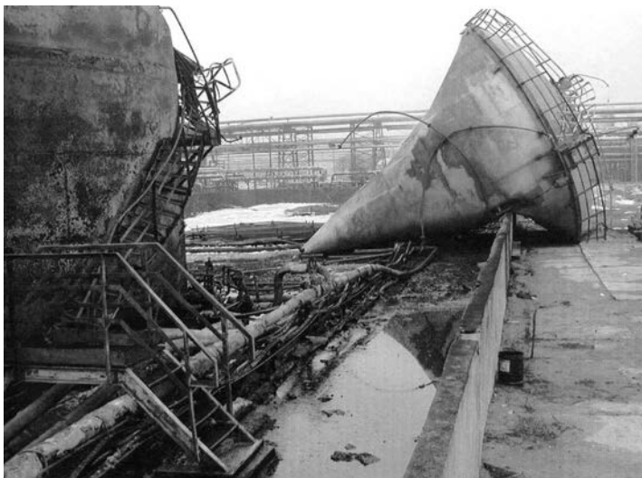
Fot. 5. Deformacja zbiornika ZM2, widoczne oderwanie od fundamentów i przemieszczenie na zewnątrz ściany betonowej.
