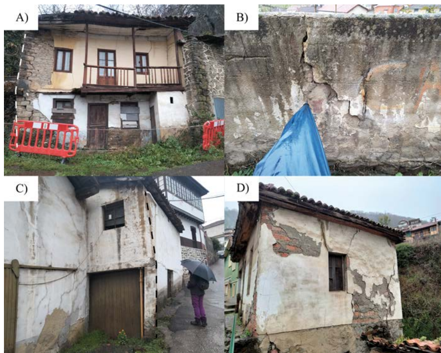
Fig. 4.- Evidencias de movimiento encontradas en Boo. A) Vivienda con múltiples daños estructurales y con evidencias de haber sufrido asentamientos diferenciales. B) Grietas en un muro junto a la vivienda de la fotografía C. C) Daños estructurales y múltiples grietas en una vivienda abandonada. D) Otra vivienda con abundantes anomalías estructurales. Ver localización de evidencias en la Fig. 3.
