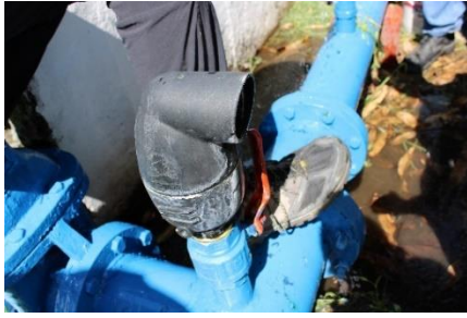
Tubería de escape de aire (negro)
